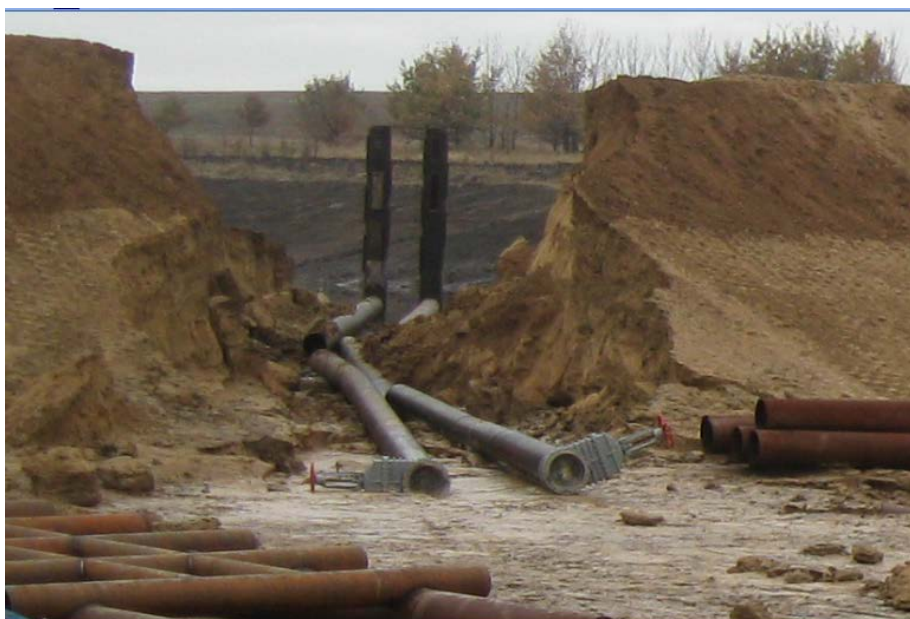
Рисунок 2 - Авария водосбросных труб одного из прудов-отстойников
